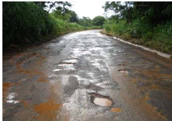
GO-060: Trecho Iporá/Arenópolis. Pavimento totalmente comprometido
