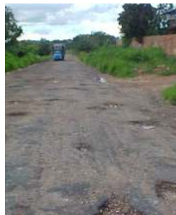
GO-070: Trecho Goiás/Uvã saída de Goiás. Asfalto sem condições de trafegabilidade
