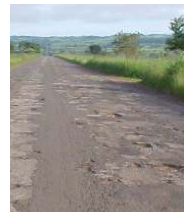
GO-154: Trecho Itaguari/Itaguari. Pavimento muito comprometido
