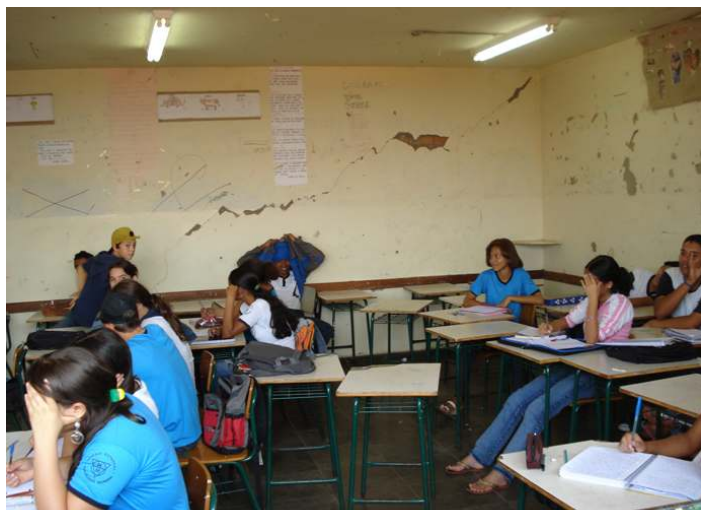
Sala de aula do bloco A: uma enorme trinca em 45°, pondo em risco a segurança dos alunos e professor
