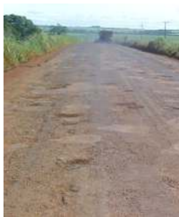
GO-347: Trecho Crixás/Santa Terezinha de Goiás. Estado precário do pavimento
