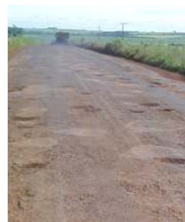
GO-174: Trecho: Rio Verde/Entr.GO-422. Pavimento deteriorado
