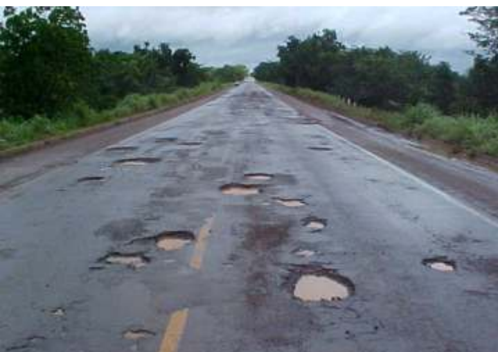
GO-164: Trecho Araguapaz/Mozarlândia/Nova Crixás. Pavimento muito danificado
